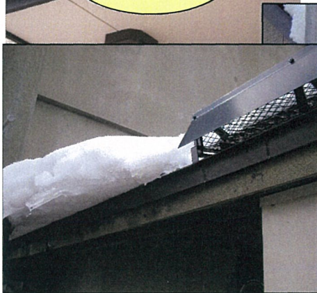
設置無、有の状況
